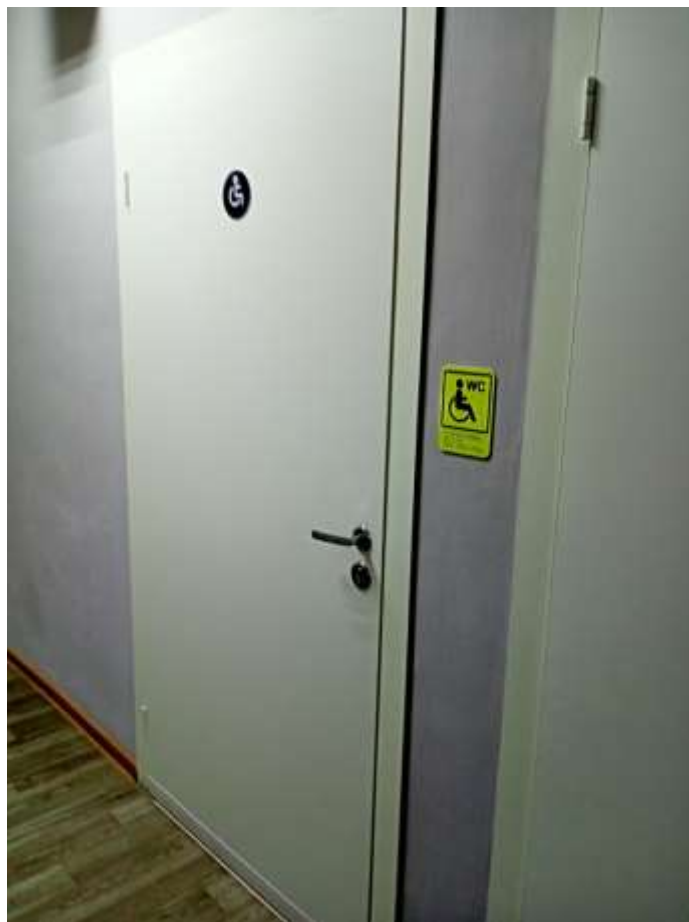
Санузел для маломобильных пользователей расположен на 1 этаже здания
